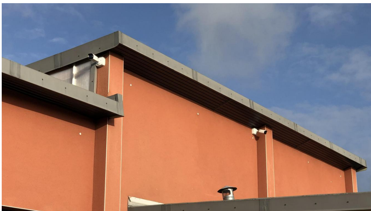
Les caméras de video-surveillance installées suite aux dégradations. - VDN
